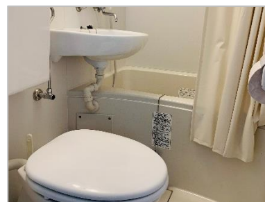
ドリーム B 棟各室ユニットバス
